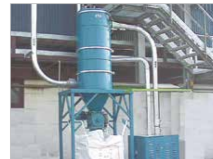
中央气泵 Central air pump
